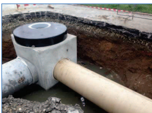
Litovel, ul. Červenská - oprava kanalizace si vyžádala neobvyklé nasazení těžké techniky. Na místě rohové šachty (uprostřed) byla stavba připomínající bunkr (vpravo) a vyměňované potrubí bylo hustě armováno
