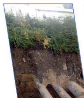
ČOV Litovel - vyhledání poruch na provozním vodovodu bylo v 5m násepě velmi složité
