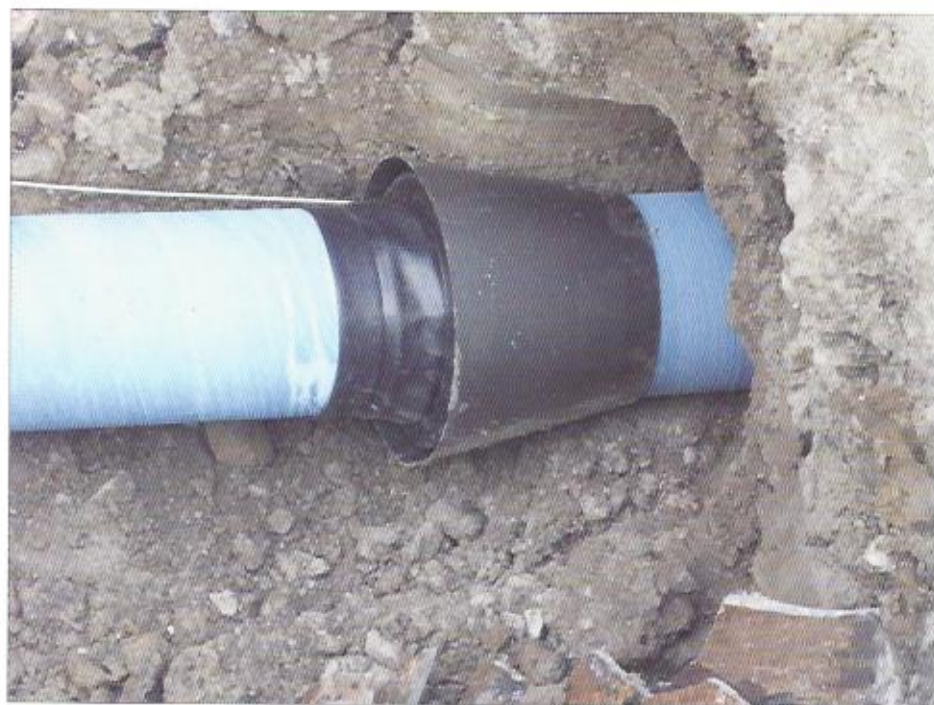
Hrdla trub při zatahování jsou chráněna pryžovými manžetami a ochrannými límci, stavba Litovel
